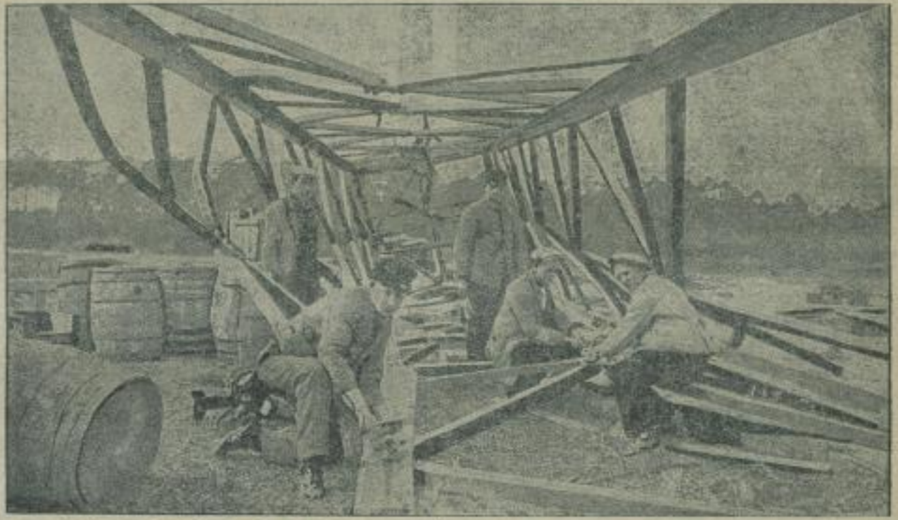
Der eingestürzte Funkturm bei Reessee.
