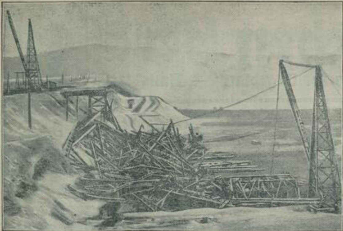
Bild links: Wieder Einsturzlaststropfe auf der Unglücksgrube „Marianne“. Auf dem Tagbau der Grube „Marianne“ b. Klein-Leipisch (Kreis Liebenwerda, Provinz Sachsen) ist am 24. Nov. eine in der Montage befindliche Abraum-Förderbrücke zum Teil zusammengebrochen. Neun Monteure fanden den Tod, während zahlreiche andere verletzt wurden. — Fast das gleich Unglück er-
