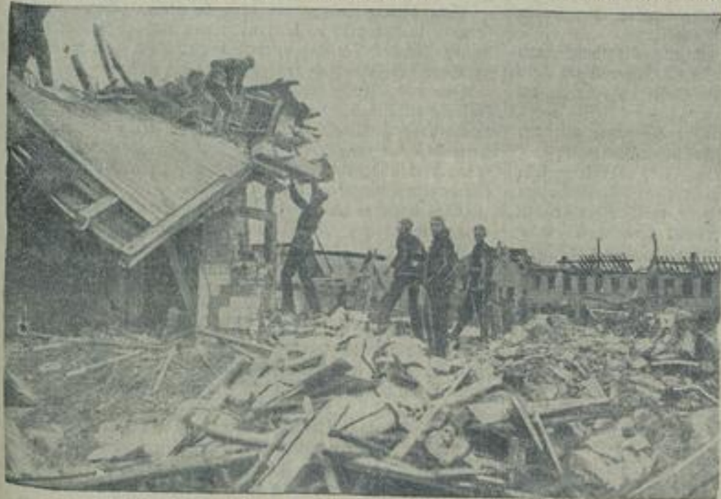
Bergungsarbeiten. Feuerwehrlente suchen nach Toten und Verletzten, die unter den Schuttmassen begraben liegen.
