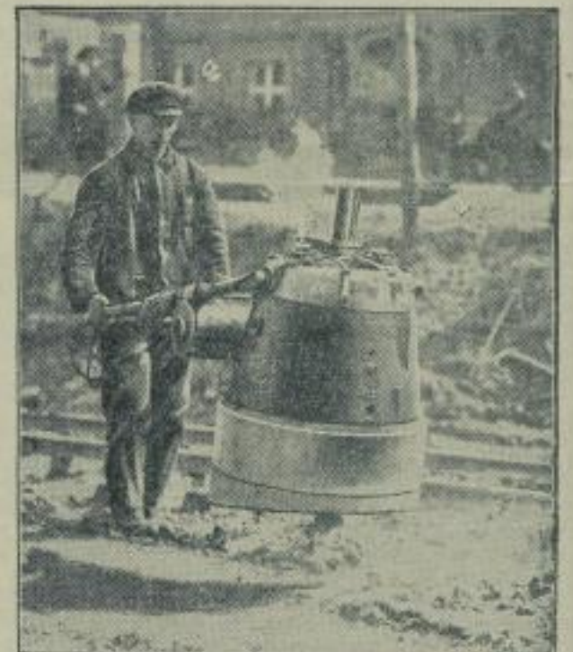
Ein neuer Straßenstampfer. Der neuerdings bei Straßenbauarbeiten immer mehr Verwendung findet: mittels eines Benzol-Explosionsmotors wird der Stampfer mechanisch in Betrieb gesetzt und kann trotz seines Gewichts von zehn Tonnern von einem einzigen Mann bedient werden.
