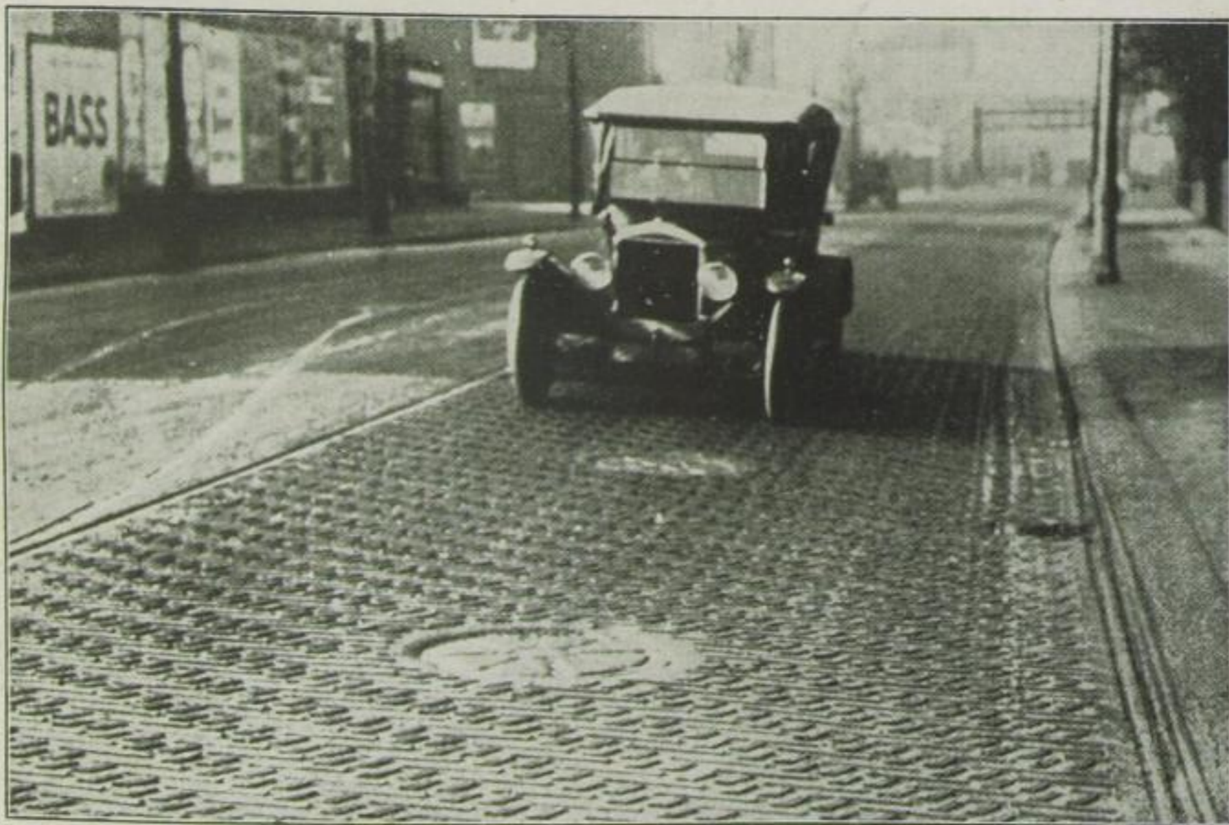
Zum Schutze gegen das Schleudern wurden in England Versuche mit Gummi-Straßenpflaster gemacht, die bisher tadellos ausgefallen sind. — Das Pflaster besteht aus kleinen Holzblöcken, die mit Gummistreifen belegt sind
