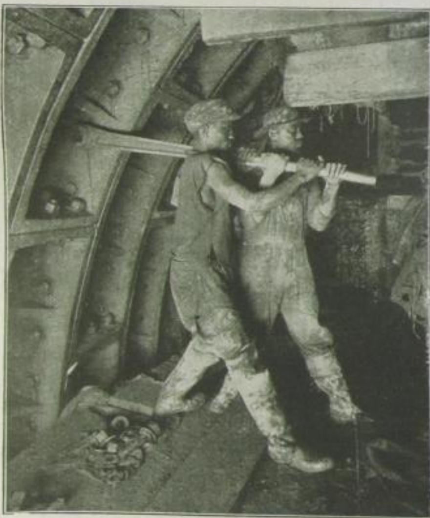
Anziehen der Schrauben zur Befestigung der Tunnelmauern im Holland-Tunnel, der als erster seiner Art ausschließlich dem Automobilverkehr dienen soll
