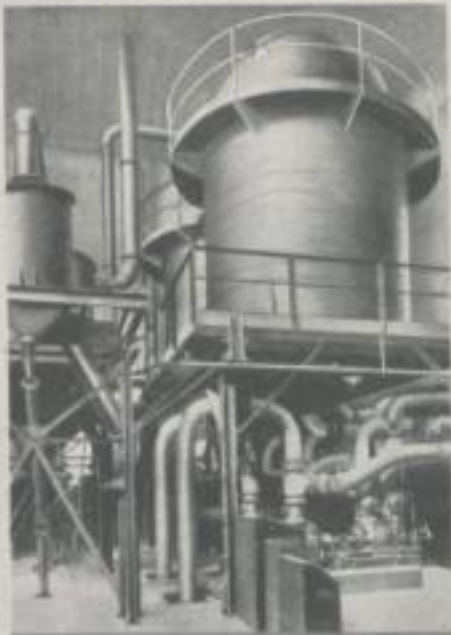
ISOLIERUNG eines Speichers für die Speicherung von A-100-MASS in Braunkohlen-Öfen. Einzigartig in seiner Bauweise. In D. hergestellt in WOLFRUMM bei HILDESDORF. Die Isolierung ist hergestellt mit SCHACKERWOL-MASSACRYL. ST. AMBROSE
