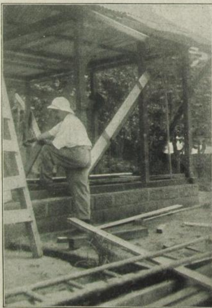
Albert Schweitzer beim Bau einer Krankenbaracke in der Missionsstation Lambarene am Ogowe, einem Parallelfluß des Kongo
