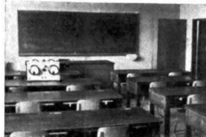
Auf jedem Tisch können elektr. Instrumente parallel mit der Hauptschalttafel geschaltet werden.
