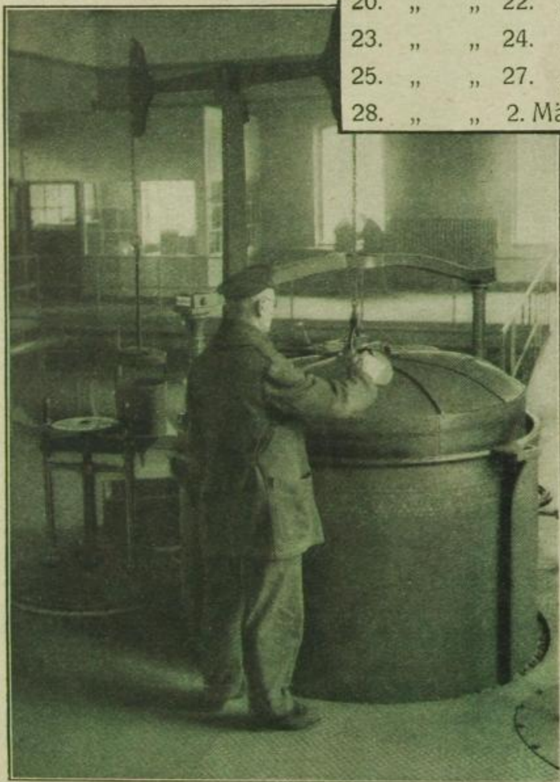
In der Gasdruckregler-Station: Mit Licht- und Klingelsignalen wird ein Beamter benachrichtigt, der auf den sogenannten „Druckregler“ einige Kilo Gewicht legt und dadurch die Gas-Zündwelle in 70000 Berliner Gaslaternen rasen läßt.
